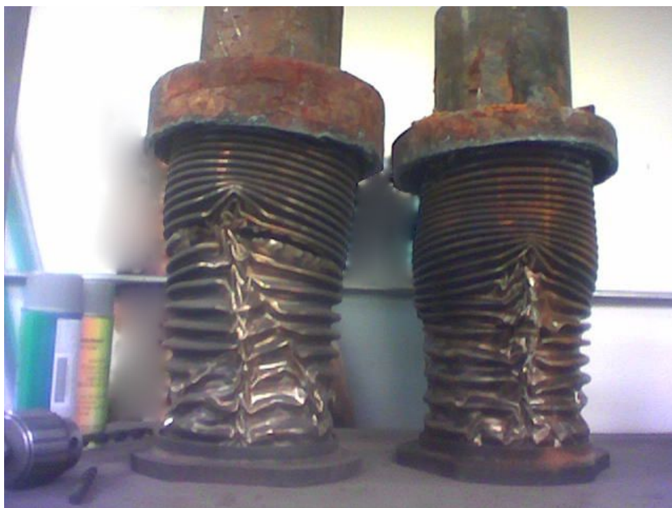
Figura 2 - Tubulação danificada por golpe de aríete.
