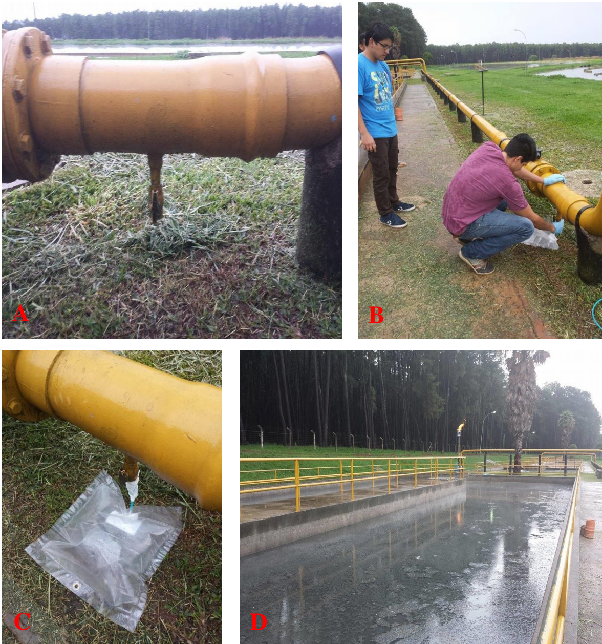
Figura 15. A) Detalhe da válvula para saída de água do sistema de canalização do biogás.
