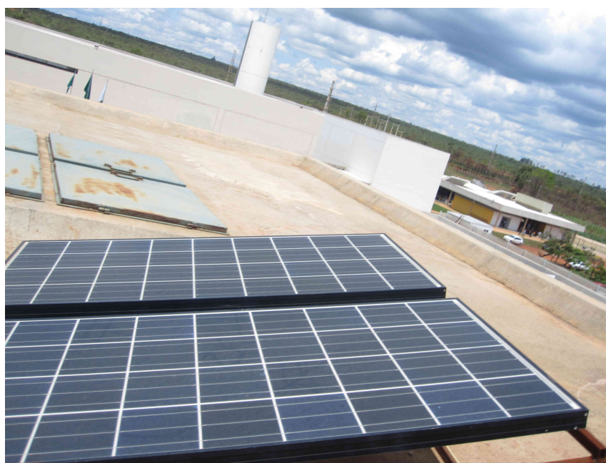
Figura 5 – Painel Solar instalado.
