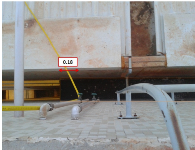
Figura 18 - Detalhe que impossibilita a aplicação da solução 1.
