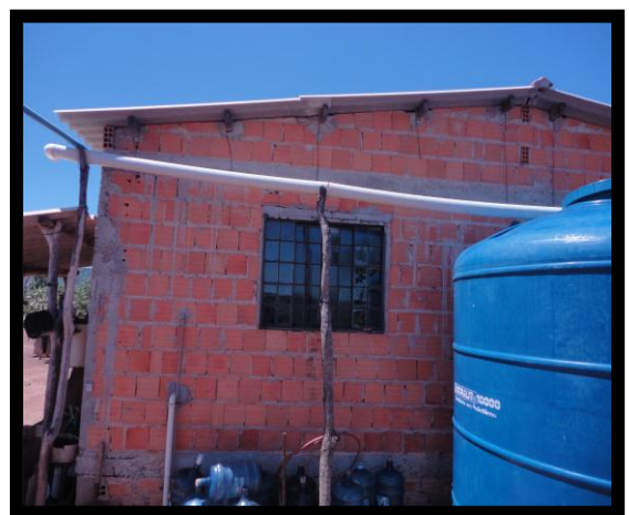
Foto 10.1 Calha improvisada para coleta de água (M,C,S, 2013).
