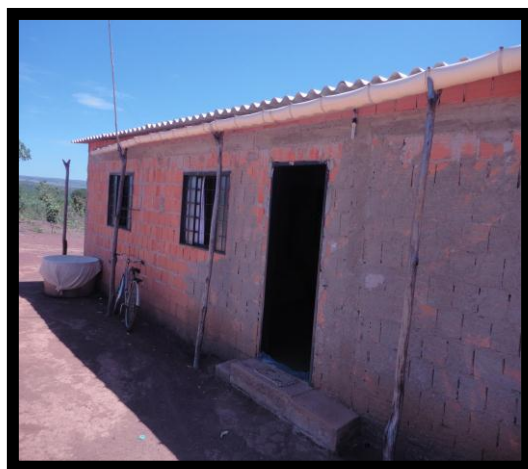
Foto 9.1 Calha para captação de água das chuvas (M,C,S 2013).
