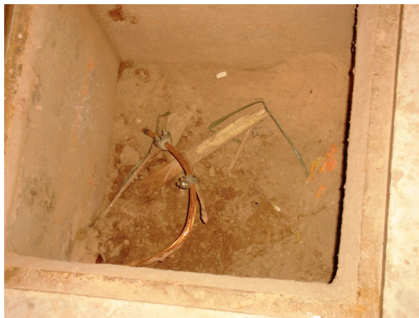
Figura 4.3 – Aterramento – Arquivo Pessoal
