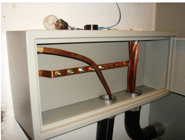
Figura A25: Barramento Equipotencial
