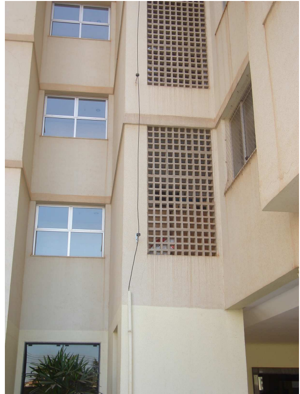
Figura A11: Condutor de Descida
