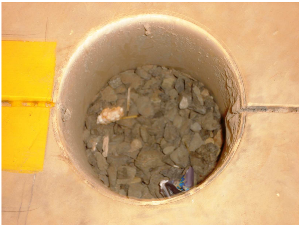
Figura A24: Caixa de Inspeção
