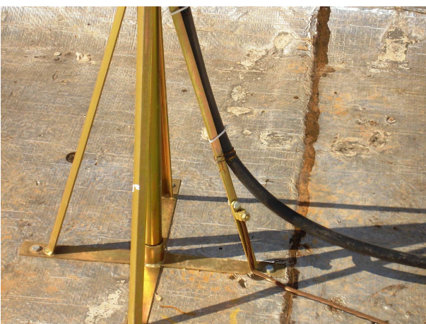
Figura A32: Aterramento Antena TV
