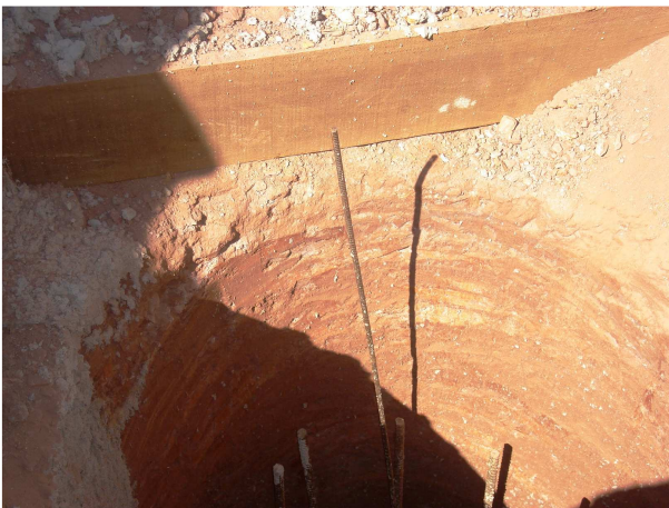
Figura A15: Detalhe Barra de Aterramento
