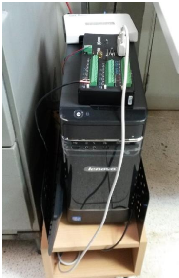
Figura 19: Servidor, datalogger e roteadores instalados na secretaria da Engenharia Mecânica da FT.
