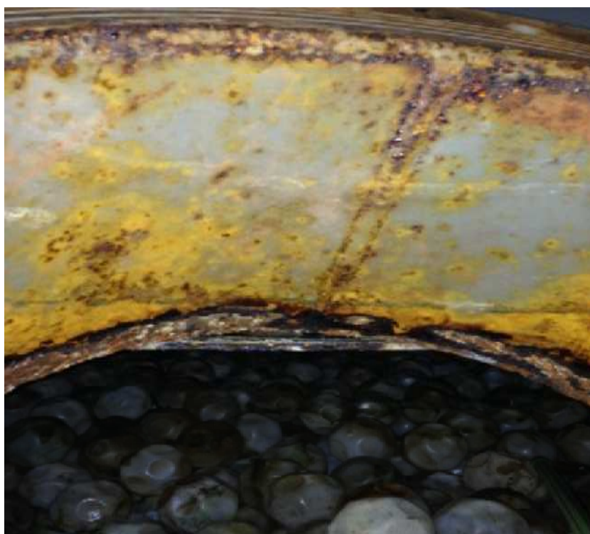
Figura 6.6. Corrosão da porta na parte superior do tanque de termoacumulação.
