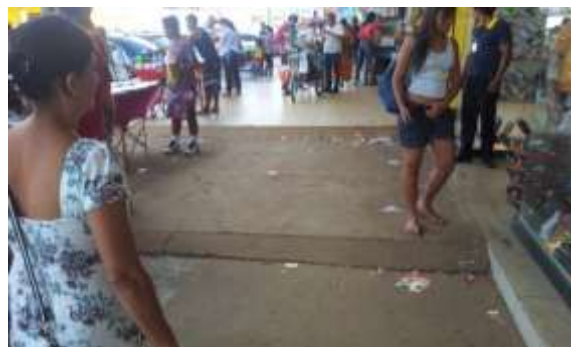
Excesso de desníveis
