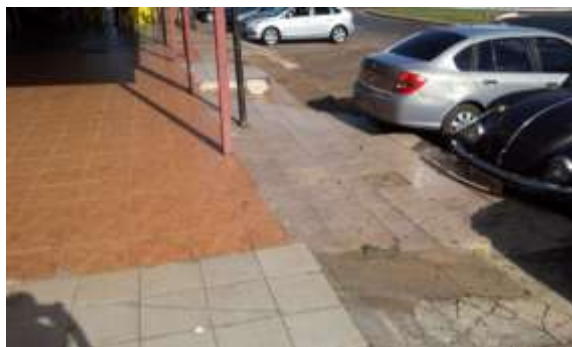
Excesso de desníveis
