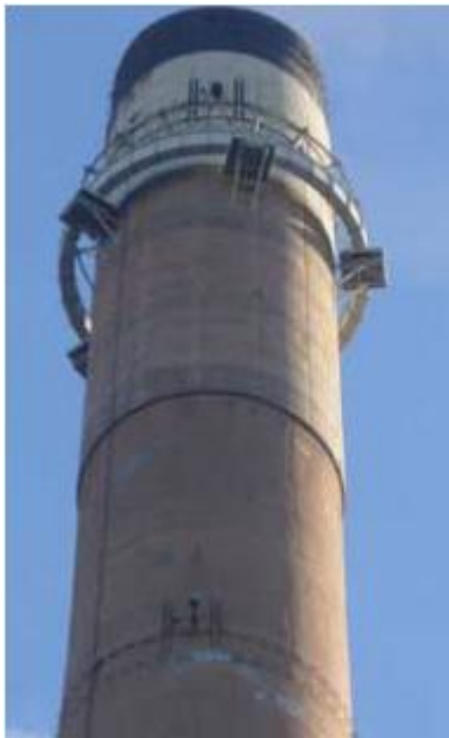
Figura 2.5. AMS em formato de anel instalado na chaminé antiga.
