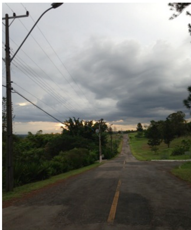
Figura 7: Via interna da Quadra 24. É evidente o seu péssimo estado de conservação. Fonte: acervo próprio.
