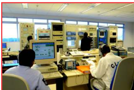
Sala de controle
