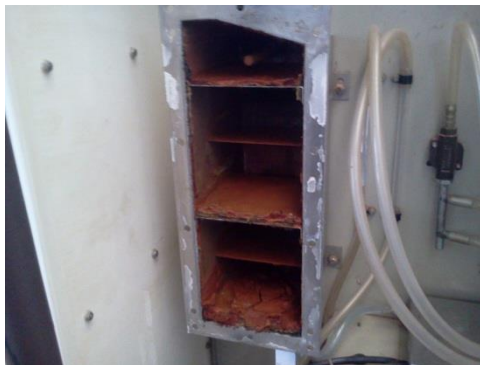
Figura 5.18 - Interior da caixa de resistências no momento em que foi aberta (foto tirada pelo autor).
