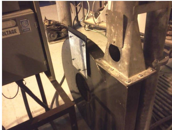
Figura 5.48 - Sistemas utilizados para variar as vazões de ar.
