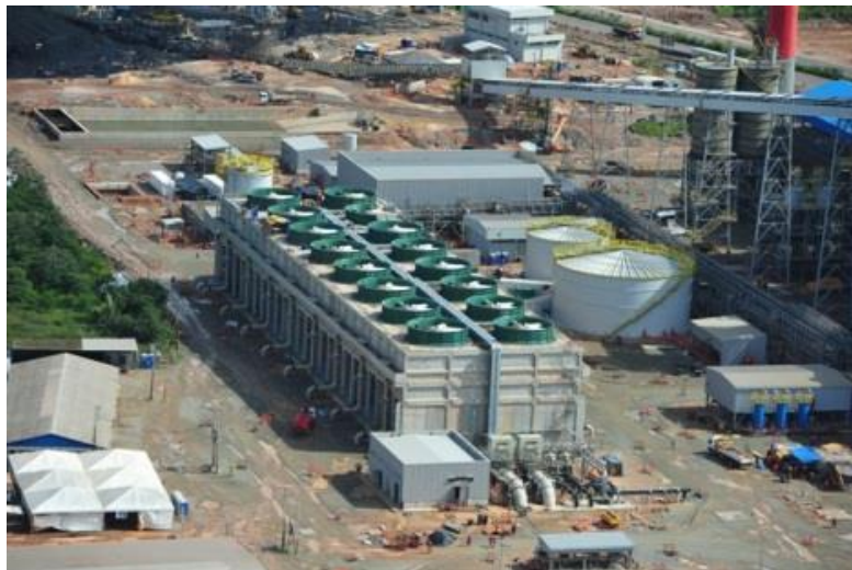
Figura 2.5 – Torres de resfriamento de tiragem mecânica em série (Fonte: http://www.flickr.com/photos/grupoebx/7068748861/ ).
