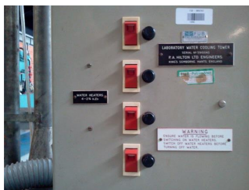
Figura 5.28 – Interruptores das resistências. (foto tirada pelo autor).
