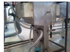
Figura 95 - Tanque coletor de água
