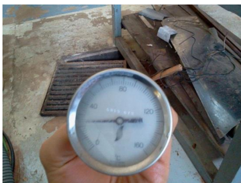
Figura 5.22 - Termômetro comprometido devido ao longo tempo sem manutenção (foto tirada pelo autor).
