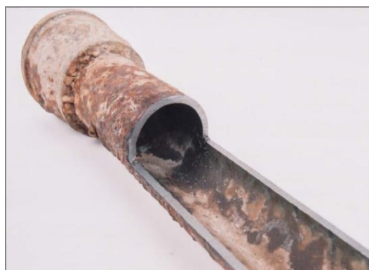
Figura 2.26 - Corrosão em tubulação (Fonte: http://www.manutencaoesuprimentos.com.br/conteudo/4148-corrosao-em-metais--principios-e-prevencao/ ).
