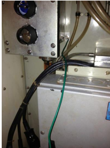
Figura 5.35 - Fio terra colocado na carcaça das resistências elétricas.
