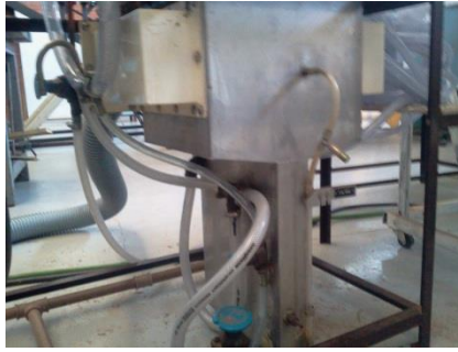
Figura 5.8 - Tanque coletor de água da bancada (foto tirada pelo autor).
