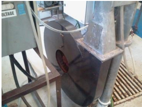
Figura 5.6 - Ventilador centrífugo da bancada (foto tirada pelo autor).
