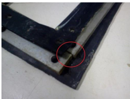
Figura 5.30 - Fresta entre partes de metal da caixa de resistências elétricas.
