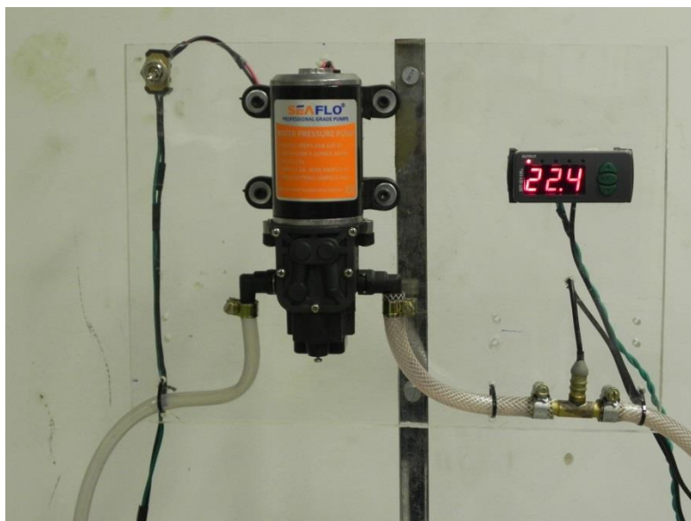
Figura 3.9 – Bomba de água pressurizada
