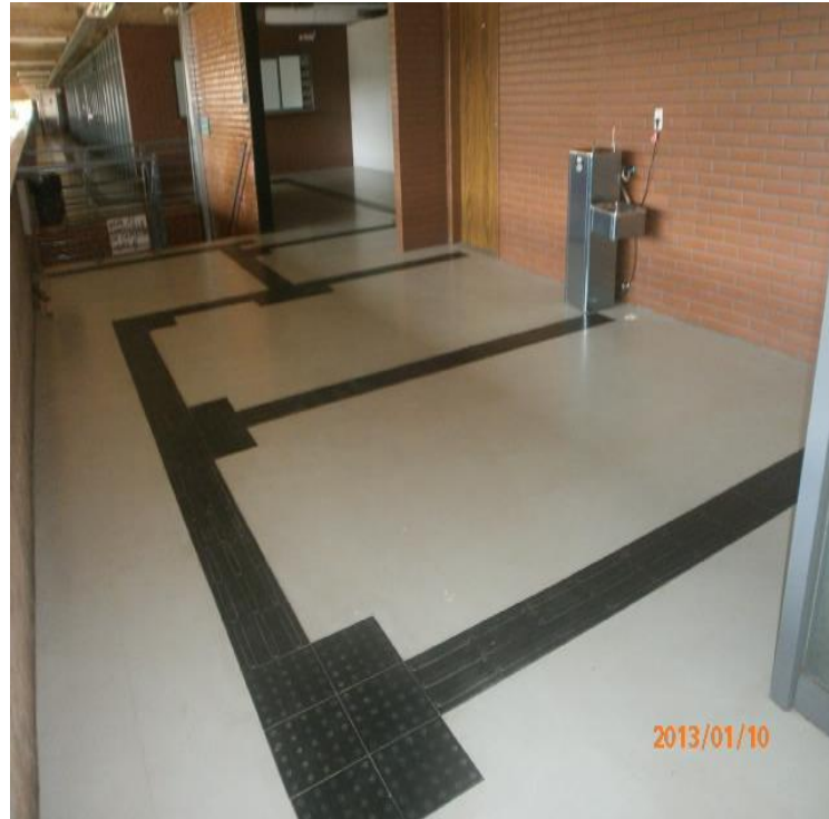
Figura 4. Corredor 1º pavimento ala B sul- Único local com piso tátil.
