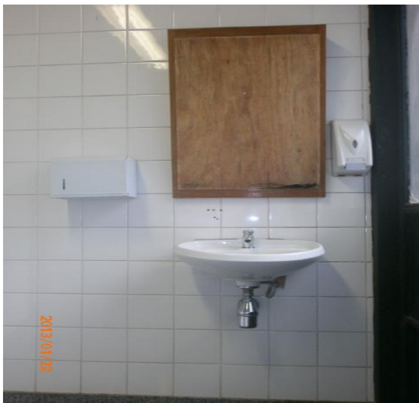
Figura 21. Lavatório e acessórios do banheiro acessível.
