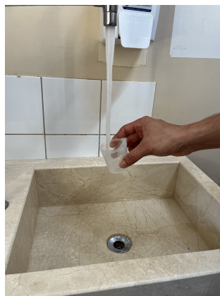
Figura 9: Realização da coleta no ponto final da rede de abastecimento. Fonte: autora.
