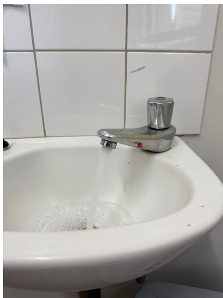
Figura 15: torneira aberta por um minuto para promover a renovação da água da tubulação.
