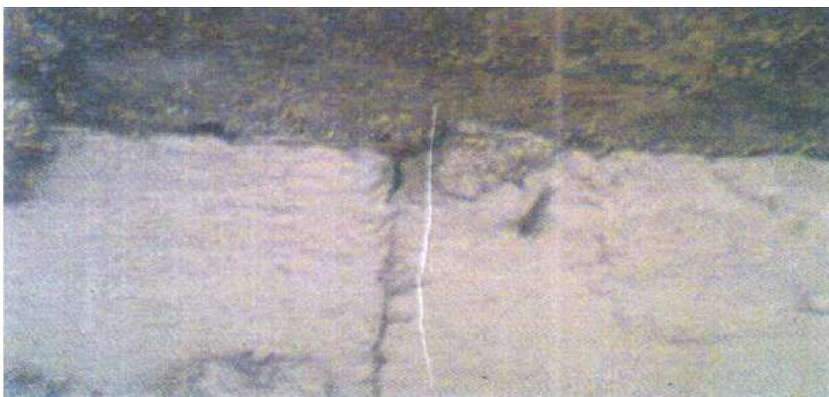
Figura 9: Fendas e rachaduras nas paredes dos silos.
