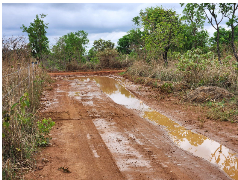
Figura 12 - Área de alagamento em estrada de chão.
