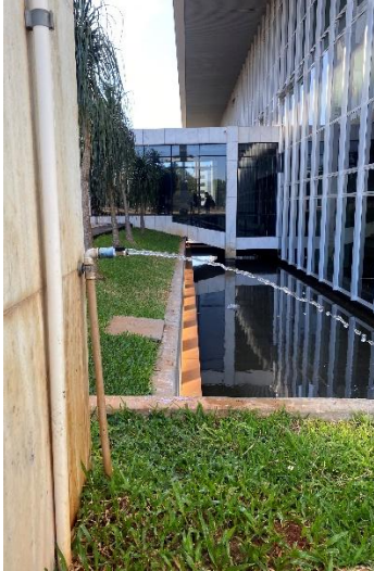
Imagem 2: água vinda de um cavalete externo ao prédio.
