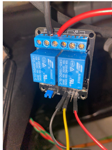
Figura 44 – Relê de acionamento Bomba de Vácuo
