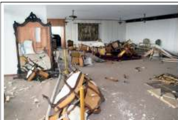
10/1/2023 – Salão Nobre destruído após os ataques de vandalismo.
