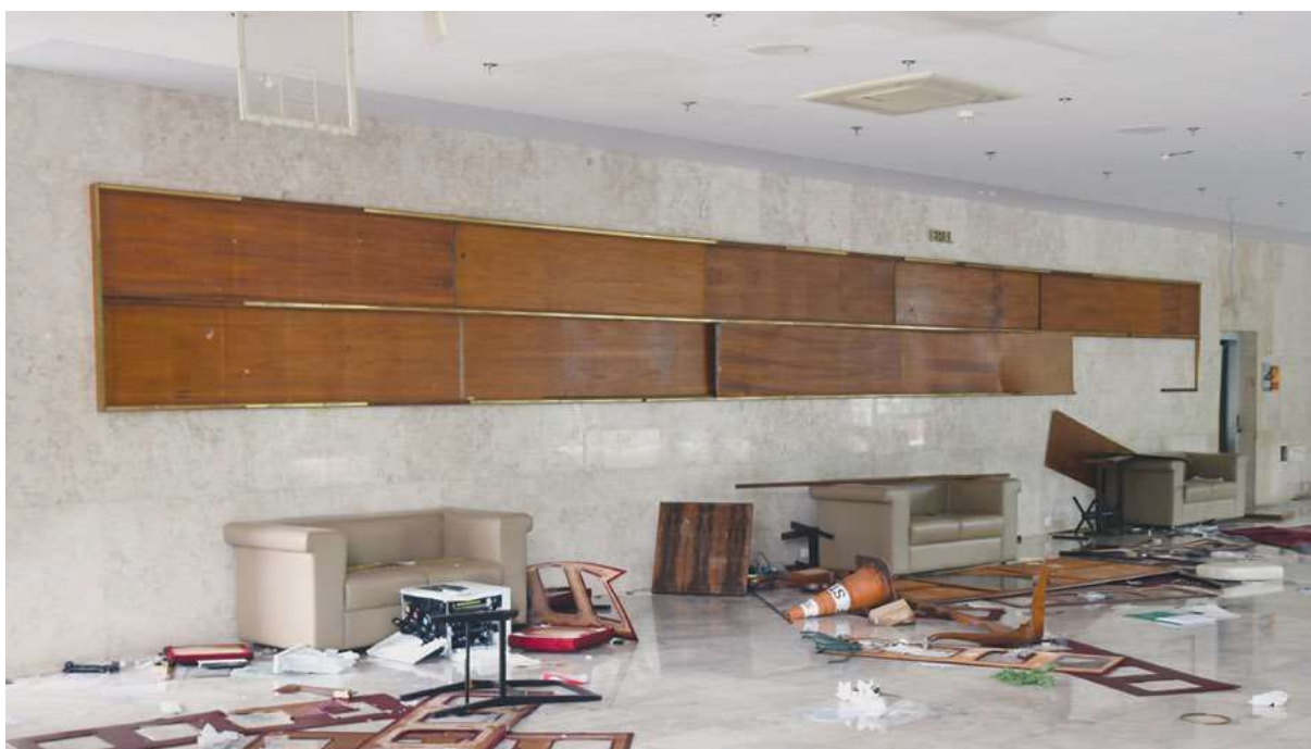
Figura 5 - Salão Branco destruído após os ataques
