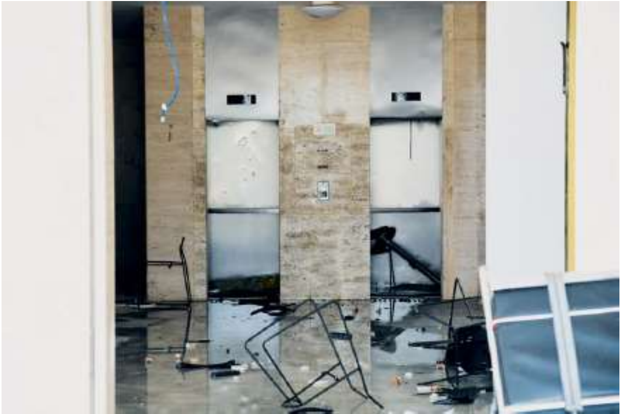
Figura 6 - Hall dos Bustos destruído após os ataques
