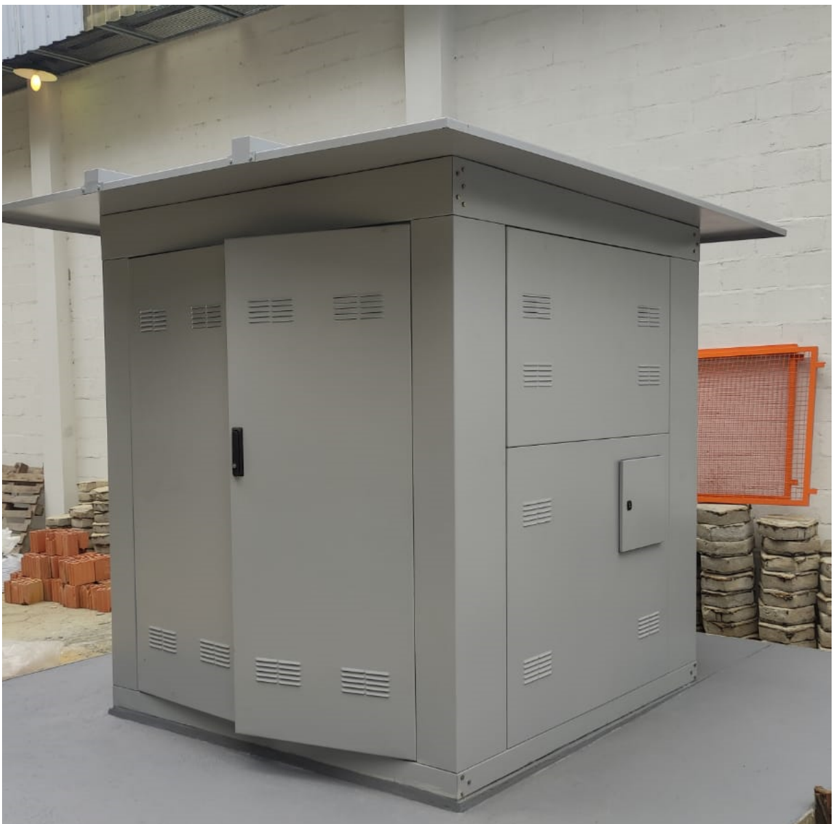
Figura 30 – Subestação de Energia da fábrica.
