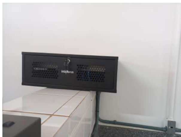
Figura I.16: Servidor Responsável por Suportar a Infraestrutura de Rede de Toda a Escola. Fonte: o autor.
