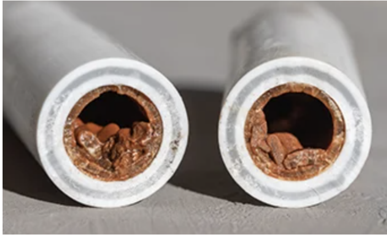
Figura 1.3: Tubulação obstruída. Retirado de: < https://www.oatey.com/faqs-blog-videos-case-studies/blog/four-reasons-why-diy-drain-cleaning-could-be-bad-idea >. Acesso em 11 de janeiro de 2024.
