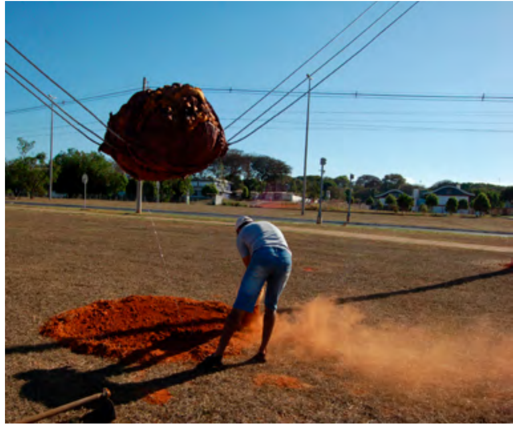
Acabamento com terra vermelha - para simular um buraco - após a instalação da SCT. Na foto, o assistente Francisco Missias.
