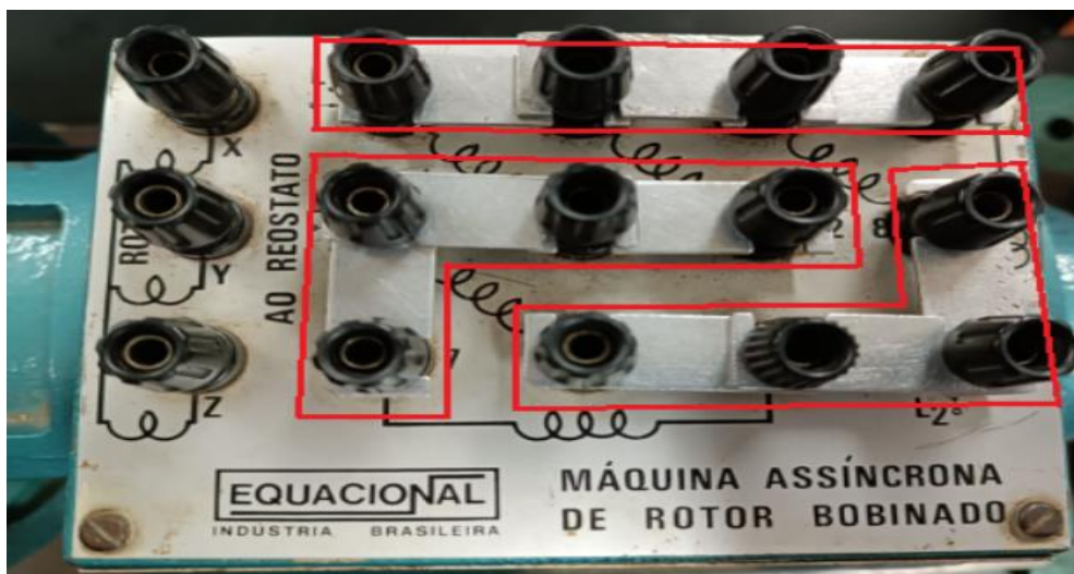
Figura 4.3 - Conexões realizadas nos bornes de entrada do estator da máquina
