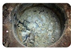
Figura 1. Caixa de gordura obstruída.
