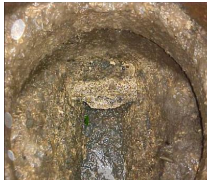
Figura 3 - Tubulação obstruída por emulsificação do óleo residual descartado com outros materiais.
