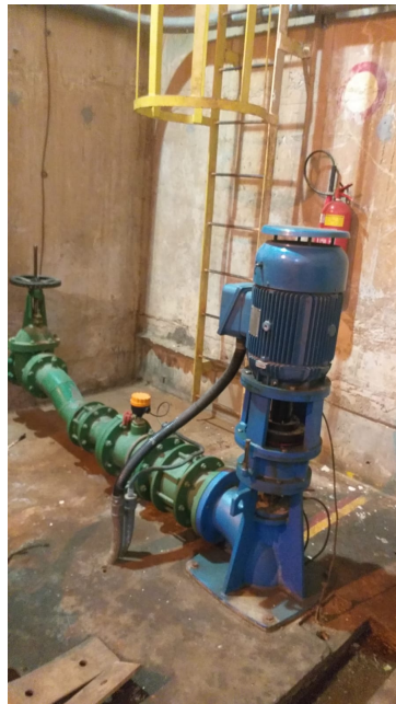
Figura 8 – bomba usada para adução e escoamento dos poços
