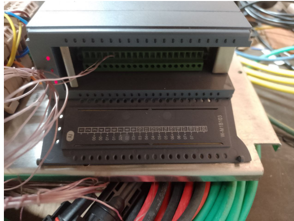
Figura 21 – Módulo de aquisição de termopares W-M1B103, em operação com termopares acoplados.
