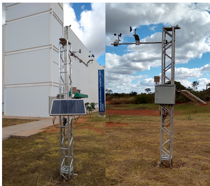
Figura 19 – Estação Solarimétrica. Fonte: Autoria Própria.
