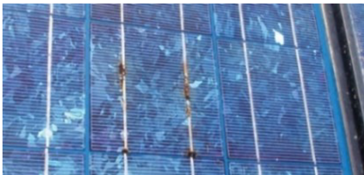
Figura 8 – Exemplo de corrosão (SILVA, 2018)
