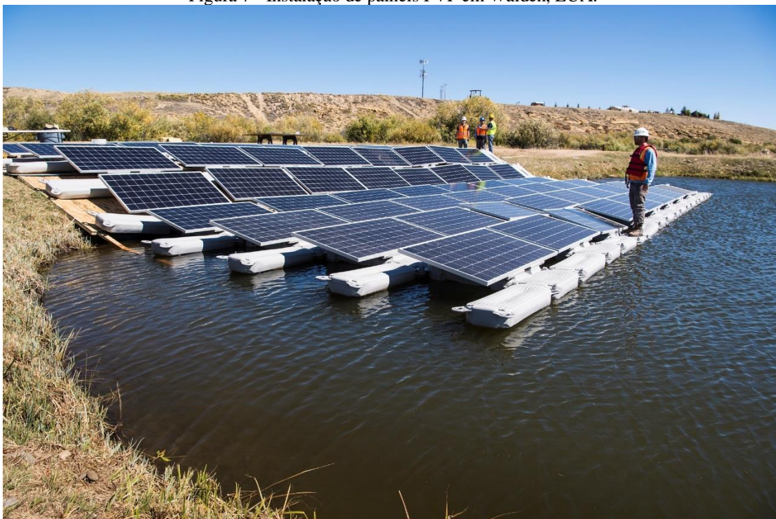
Figura 7 - Instalação de painéis FVF em Walden, EUA.
