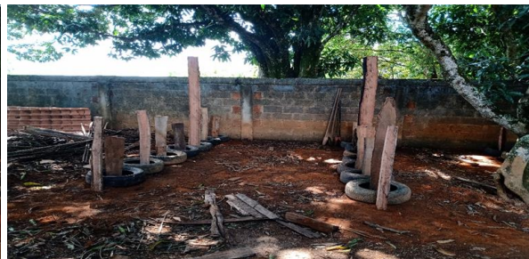
Foto 13: Tábuas colocadas para preservação dos buracos.
