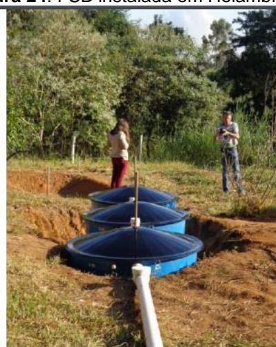
Figura 24: FSB instalada em Holambra-SP
