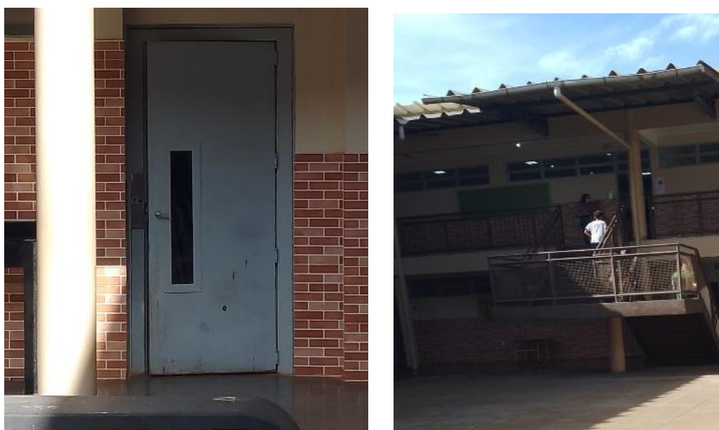
Figura 2: apresenta o elevador, sem utilização por estar quebrado, e a escada de acesso.
