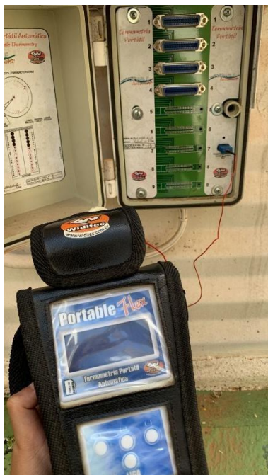
Figura 19: Medidor de temperatura do Silo. Fonte: Thainá Alves Farias (2022)
