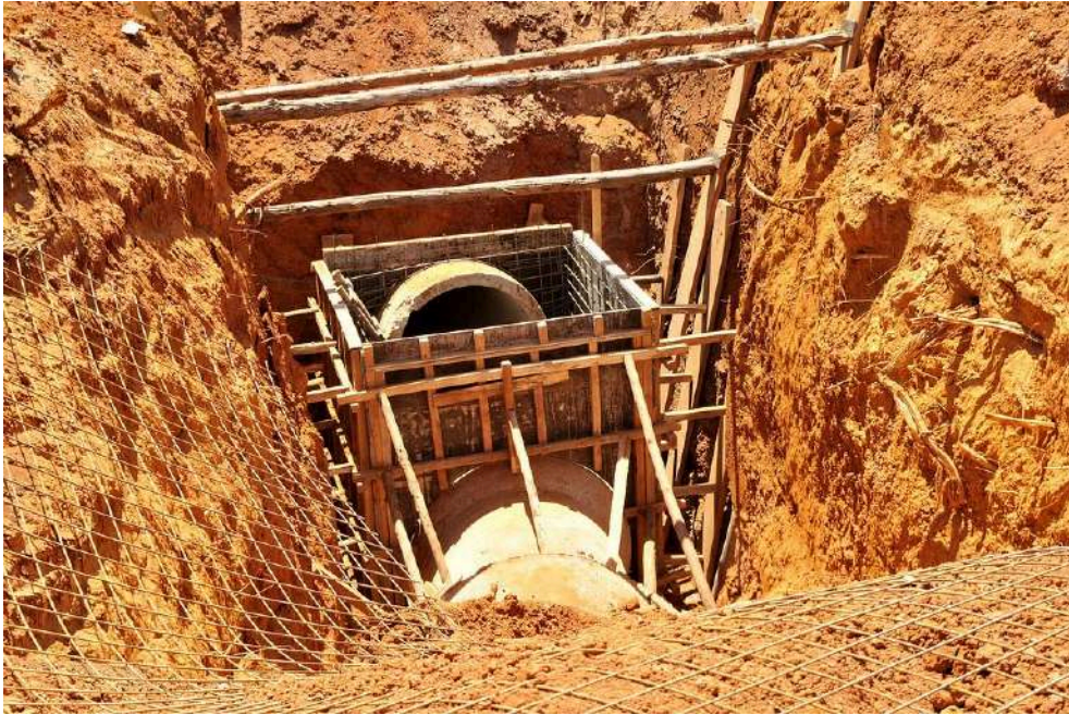
Figura 2 - Sistemas de tubulações subterrâneas.
