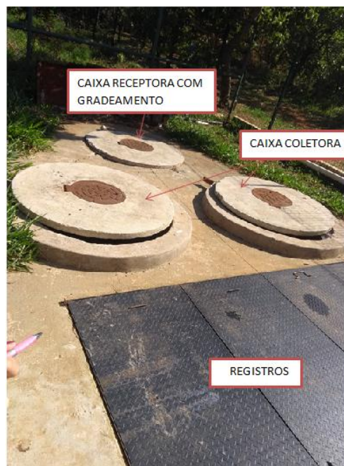
Figura 5: Estação Elevatória de Esgoto da FUP. Foto: própria autora
