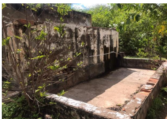
Figura 10 – Reservatório de água do poço artesiano
