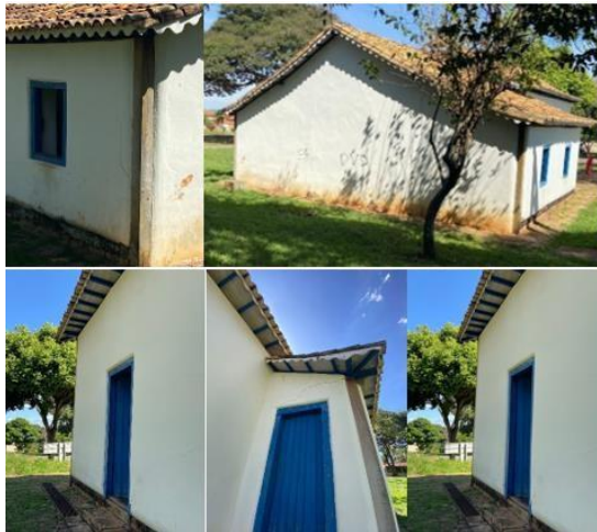
Figura 52 - Indícios de má conservação e preservação da Igreja São Sebastião.
