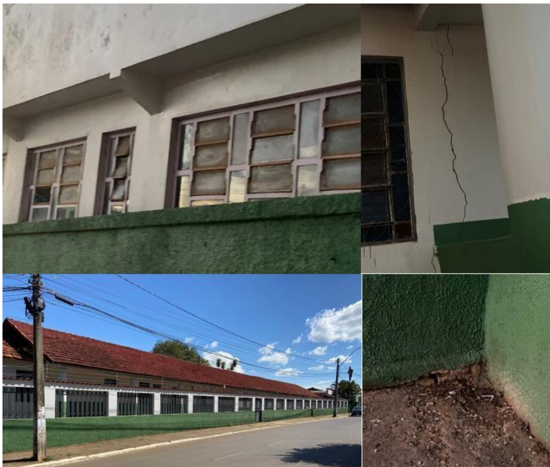
Figura 64 - Indícios de má conservação e preservação.
