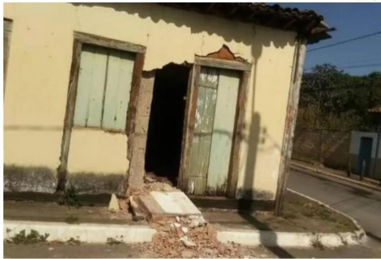
Figura 16 - Casa de Dona Negrinha desmoronando.
