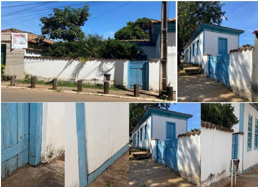
Figura 55 - Indícios de má conservação e preservação no Museu.
