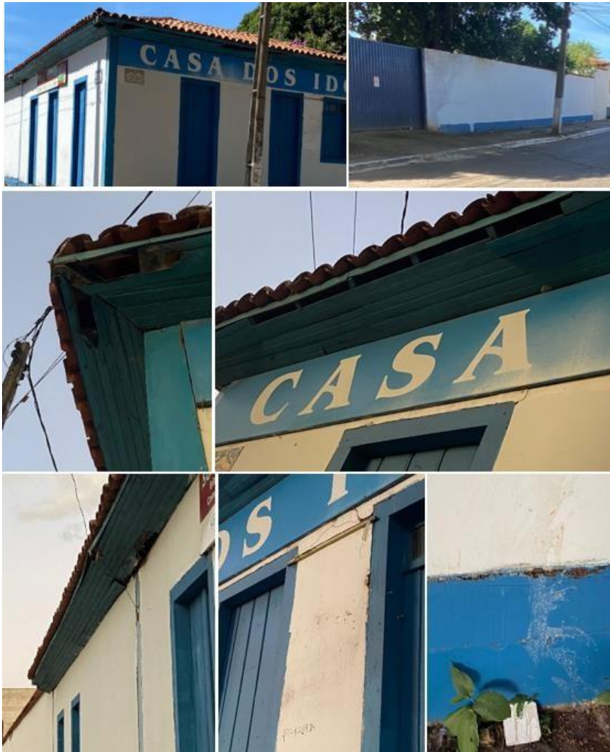
Figura 58 - Indícios de má conservação e preservação da "Casa do Idoso"
