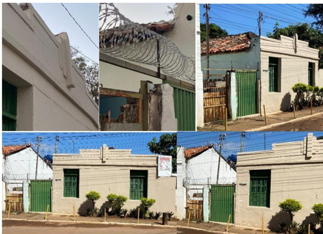
Figura 63 - Índícios de má preservação e conservação.
