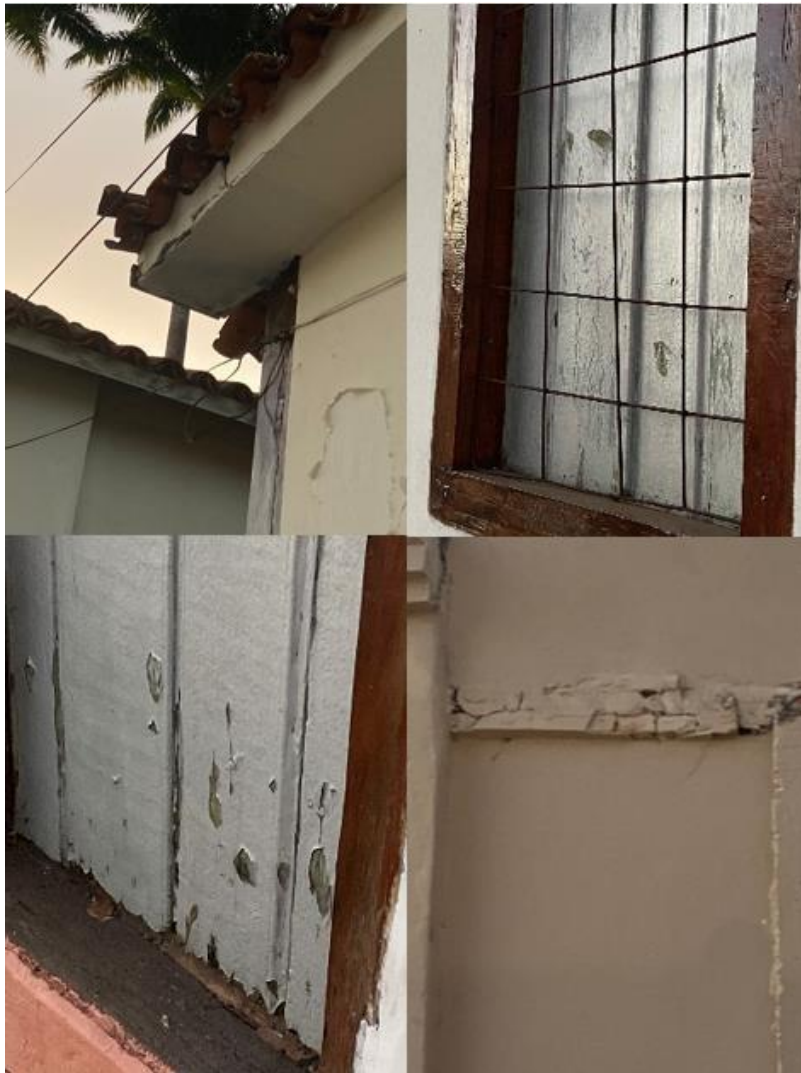
Figura 65 - Indícios de má conservação e preservação do Hotel O Casarão.
