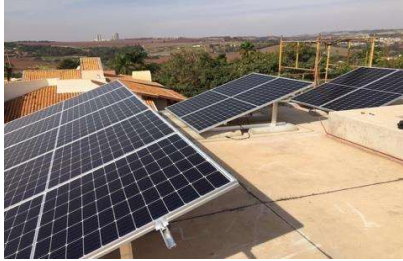
Sistema em Condomínio 12kWp
