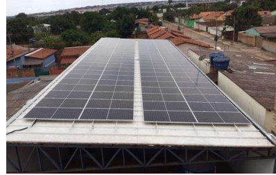
Sistema Comercial 53kWp
