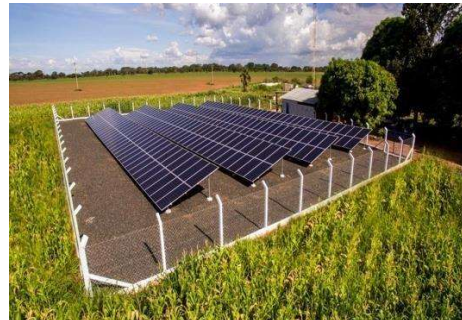
Sistema em Solo Fazenda (AGRO) 75kWp
