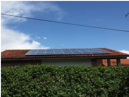
Sistema Residencial 9.8kWp
