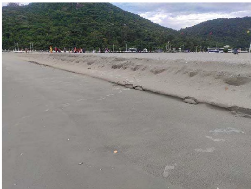
Figura 12 - Processos erosivos formados após obra de alargamento
