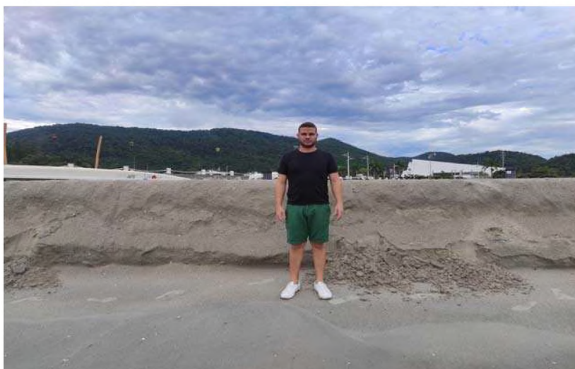
Figura 11 - Processos erosivos formados após obra de alargamento
