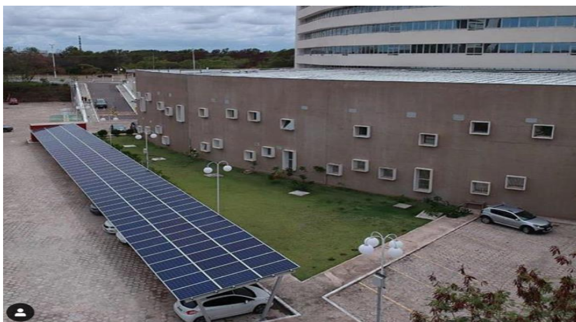
Figura 4.3 Projeto da Sonnen Energia em parceria com a Solarfix, para a instalação do estacionamento fotovoltaico. Fonte: Rede social da Sonnen Energia
