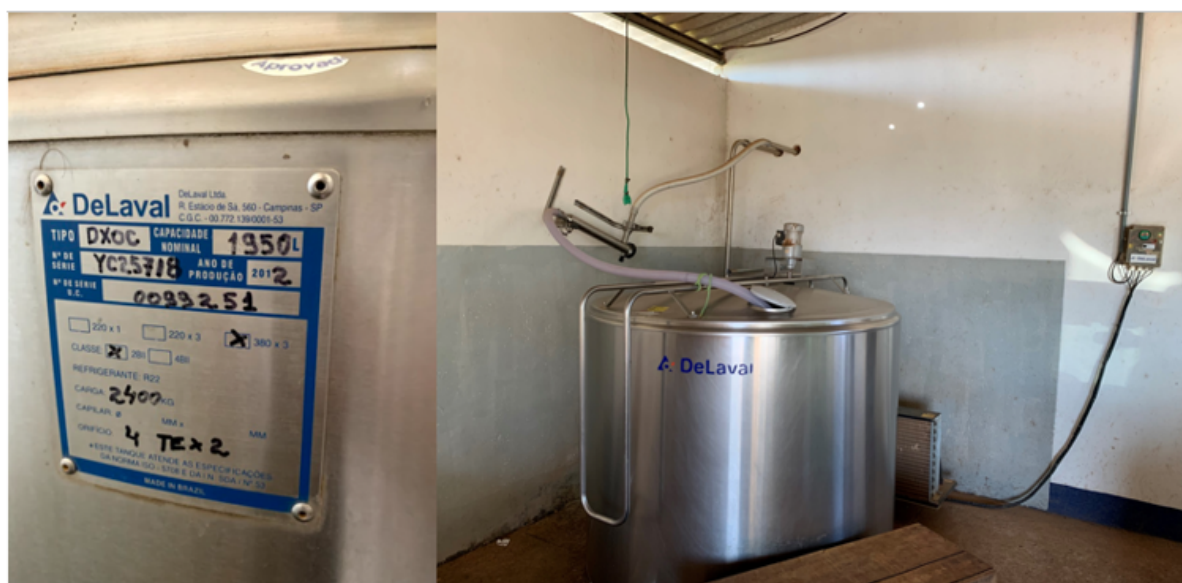
Figura 5.4: Equipamento de refrigeração e armazenamento de leite. Fonte: Autoral.
