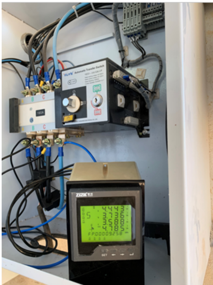
Figura 5.1: Medidor de energia elétrica instalado. Fonte: autoral
