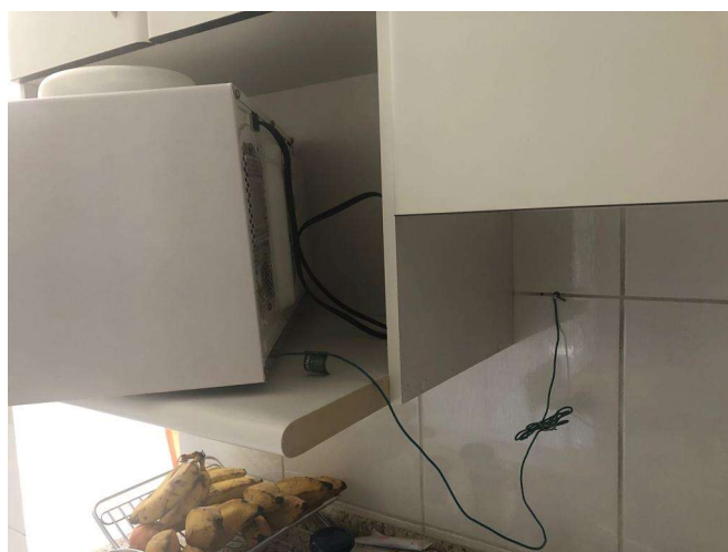
Foto 3.10: condutor de proteção conectado a um prego na parede.
