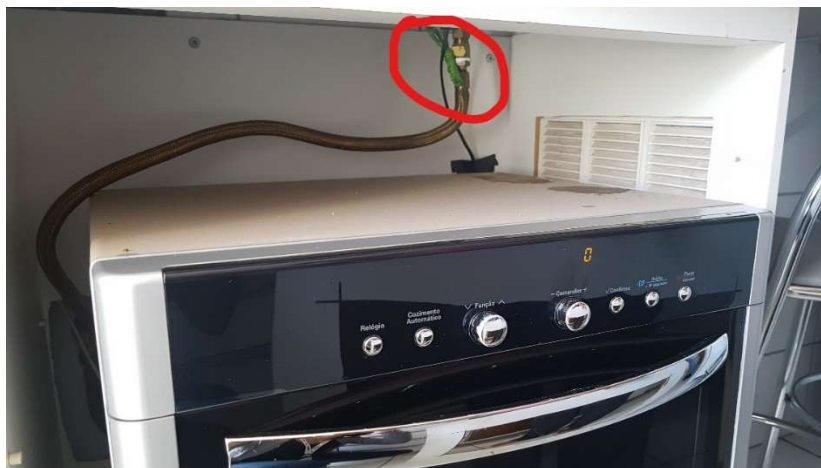
Foto 3.8 - condutor de proteção do equipamento desconectado do terceiro pino.
