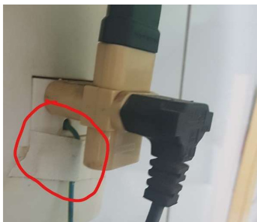
Foto 3.9 - condutor de proteção inserido de forma inadequada no orifício de aterramento da tomada antiga.
