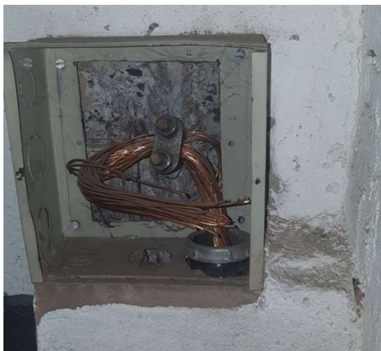
Foto 2.11 - Cordoalha de cobre como condutor de aterramento.
