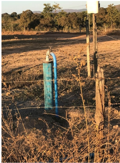
Figura 6.5: Poço tubular sem proteção sanitária adequada, não cadastrado no SIAGAS. Ponto 123, coordenadas UTM: Zona 23S, N 8.144.323, E 297.549.
