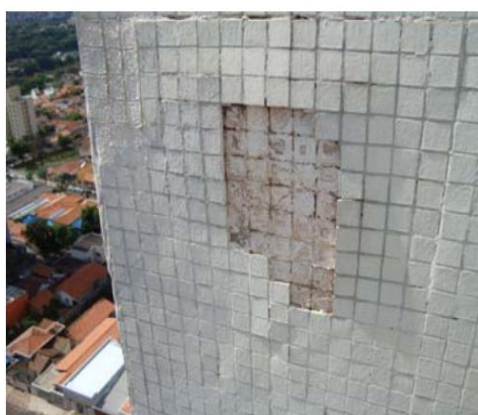
Figura 2.6 – Descolamento cerâmico (GALLETTO, 2013)
