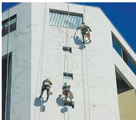
Figura 2.5 - Fissuras em fachadas (SAHADE, 2005)
