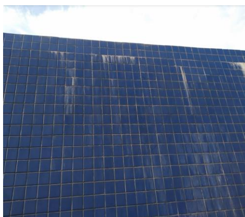
Figura 2.4 - Eflorescência (Acervo próprio)
