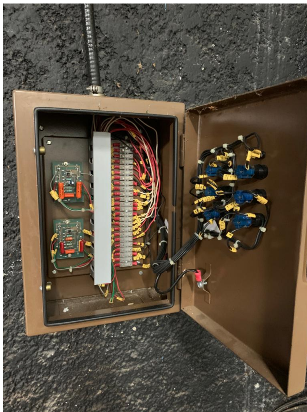
Figura 57 – Quadro 2 do auditório
