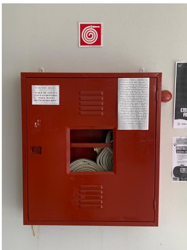
Figura 65 – Mangueira de incêndio tipo 1 FE5
