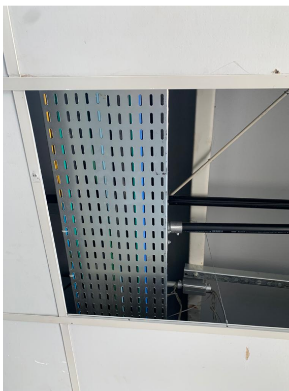
Figura 18 – Eletrocalha para linhas elétricas.
