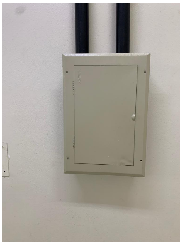
Figura 62 – Porta do quadro do corredor do banheiro
