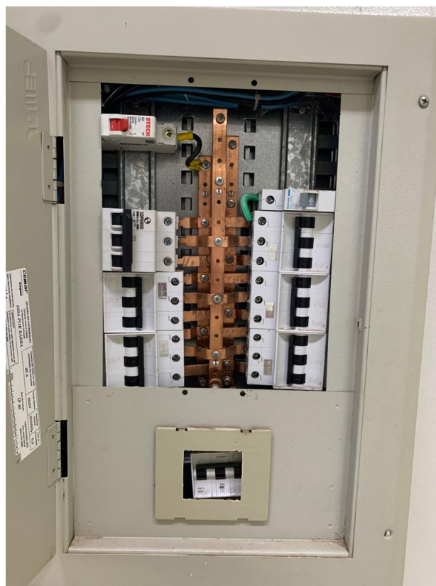
Figura 61 – Quadro do corredor do banheiro
