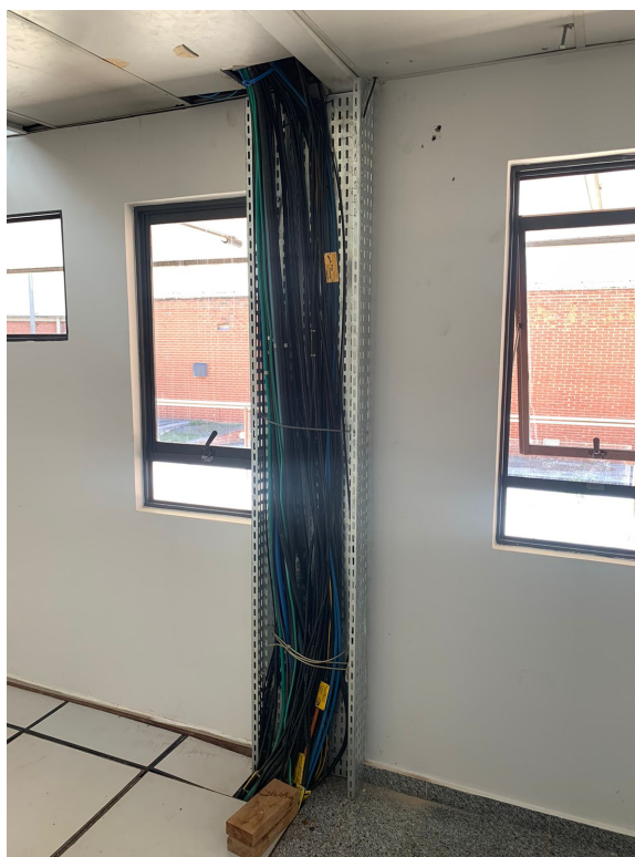
Figura 34 – Eletrocalha para cabeamento estruturado
