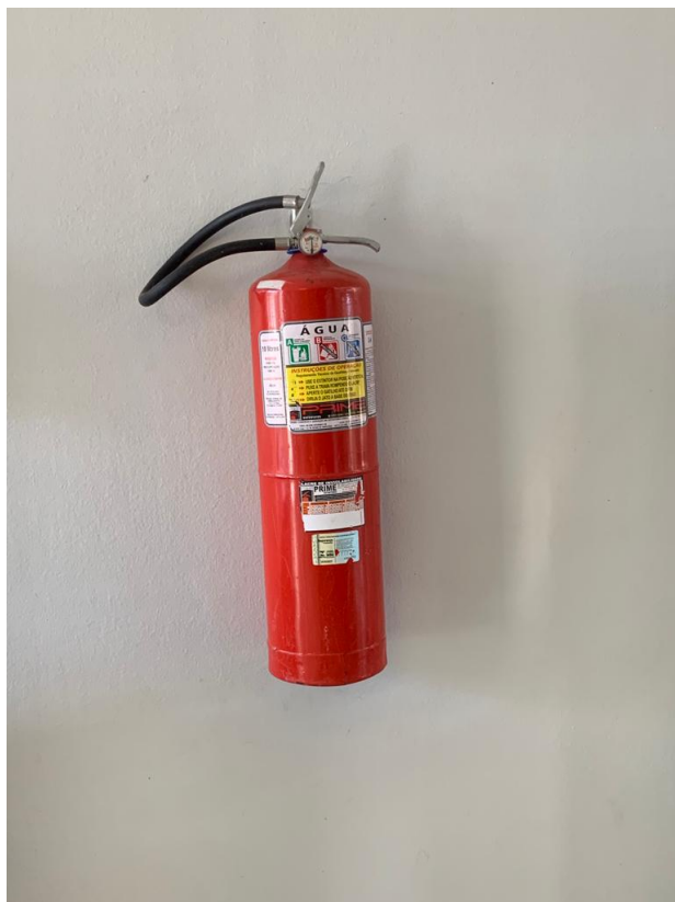
Figura 64 – Extintor de incêndio FE5
