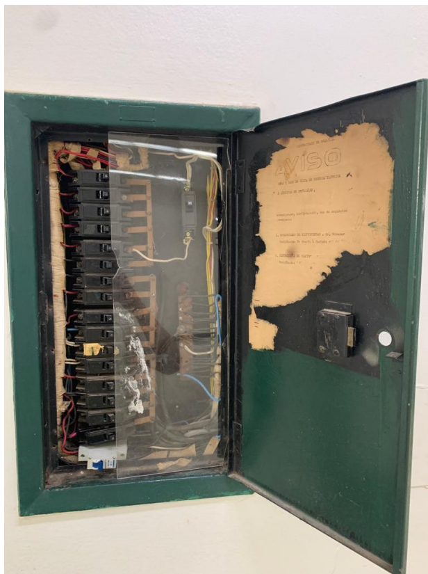
Figura 59 – Quadro do corredor do banheiro
