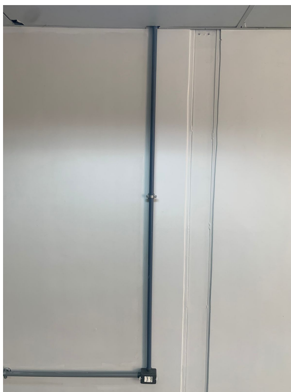
Figura 22 – Eletroduto com tomada de uso geral.
