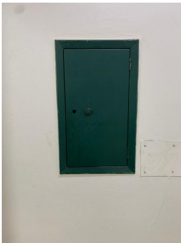
Figura 60 – Porta do quadro do corredor do banheiro
