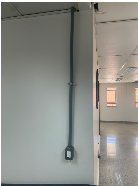
Figura 20 – Eletroduto com interruptor.
