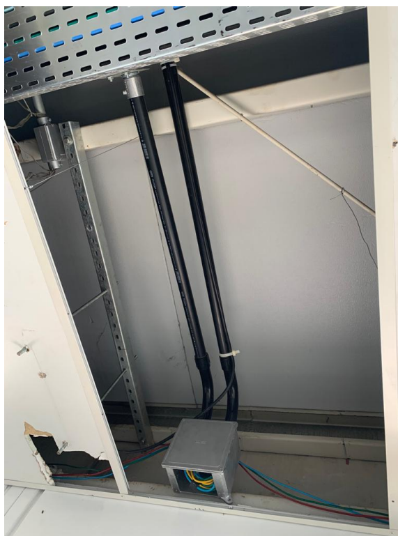
Figura 19 – Eletrocalha e eletrodutos para linhas elétricas.
