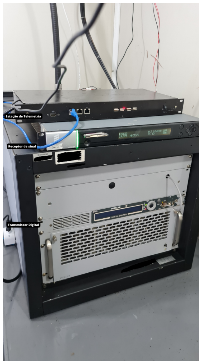
Figura 16 – Estação de telemetria instalada no abrigo.
