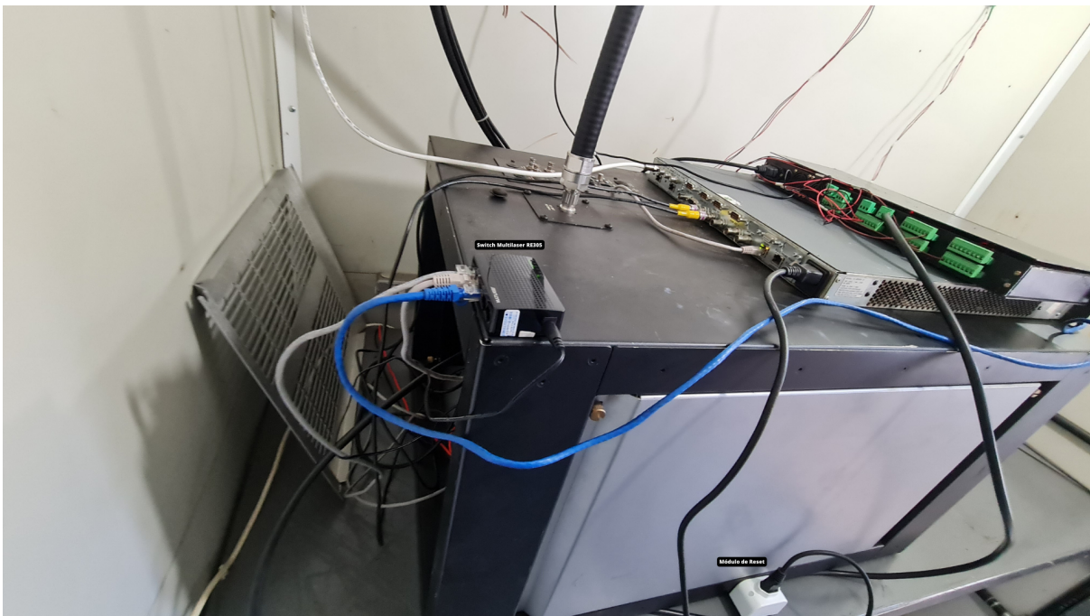
Figura 18 – Switch de rede e módulo de reset instalados.
