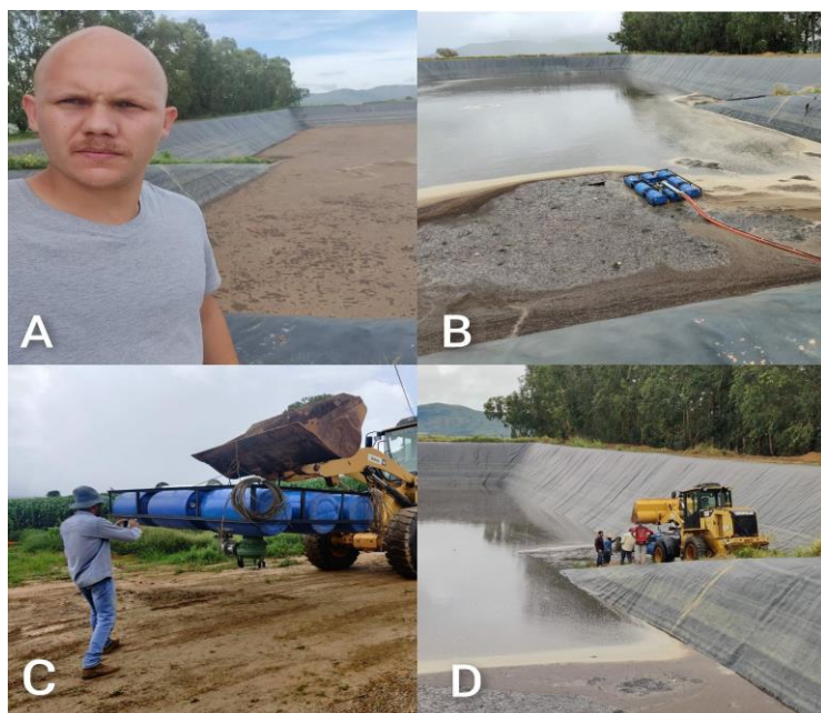
Figura 3. Foto junto a barragem principal de dejetos (A); Balsa com conjunto motobomba submerso e mangote instalados na barragem (B); Última avaliação para instalação do conjunto (C); Equipe soltando a balsa pela primeira vez (D).
