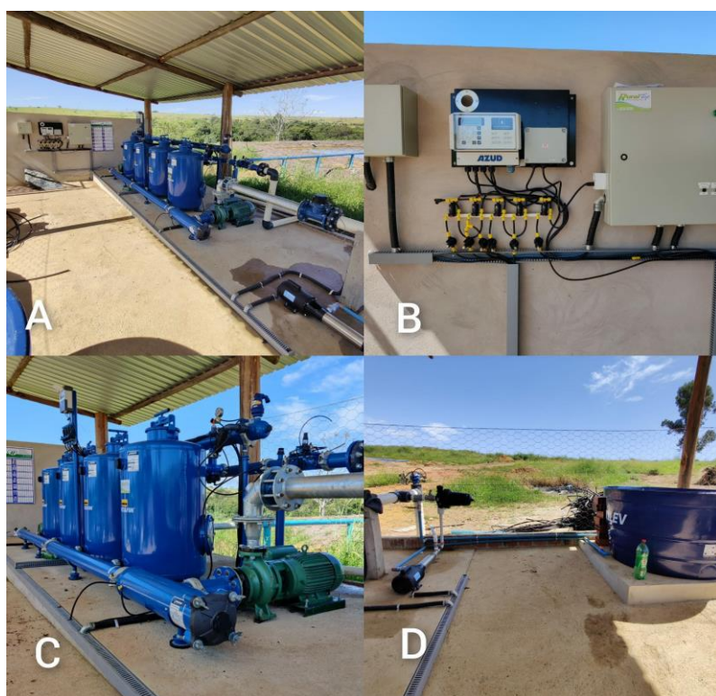
Figura 5. Imagem geral da casa de bombas (A); Componentes utilizados para automação do sistema (programador e solenoides) (B); Conjunto de filtros de areia autolimpantes Netafim utilizados (C); Sistema de fertirrigação com motobomba instalado (D).
