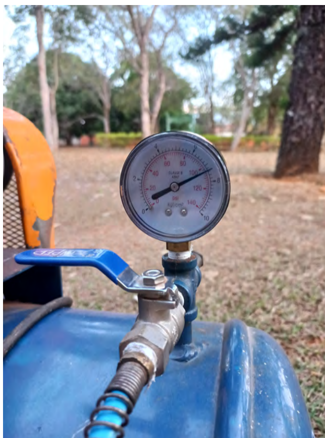
Figura 6.11: Manômetro e válvula do compressor de 120 psi.
