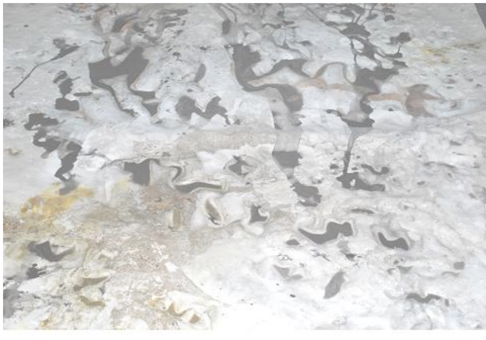
Figura 11: Detalhe das manchas ainda úmidas
